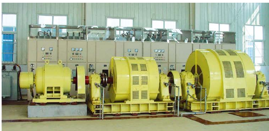
3000kV Generator Unit
